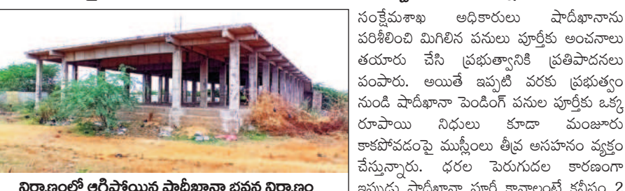
నిర్మాణంలో ఆగిపోయిన పాటిభానా భవన నిర్మాణం
